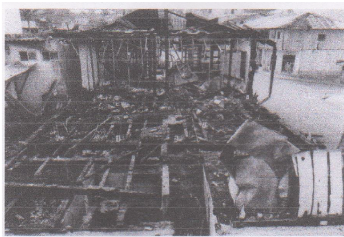
Imagen 3. Edificación luego del incendio. Fuente: Informe del Cuerpo de Bomberos Nro.58-AII-DP-CBDNQ-2018.
