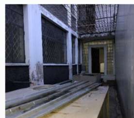
P2.3 TERRAZA CON EQUIPOS DE A/C
