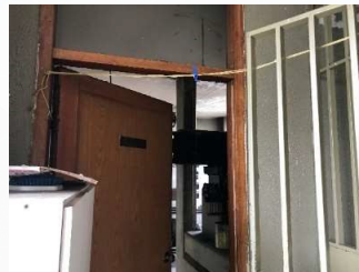
P6.3 CUARTO MAQUINAS ASCENSOR
