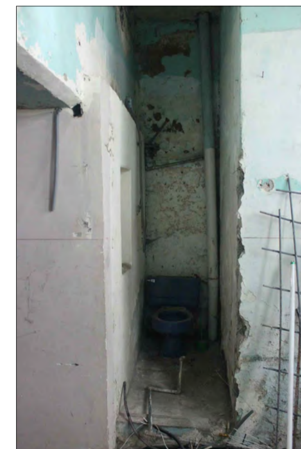
1 Planta baja, sanitario y lavabo añadidos sobre espacio de galería en torno a patio central.
