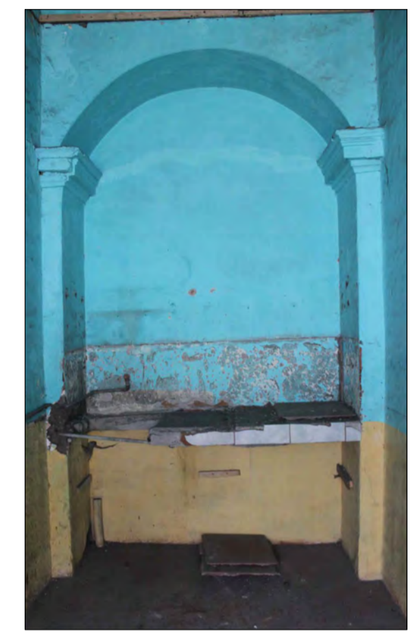
1 Planta alta, cierre añadido de bloque, mesón y cerámicos añadidos
