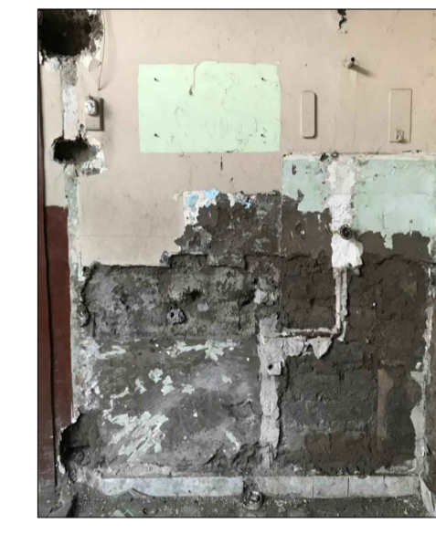
10. RESQUEBRAJAMIENTO DE ENLUCIDO, DESPRENDIMIENTOS POR INTERVENCIÓN EN EL ADOBE
