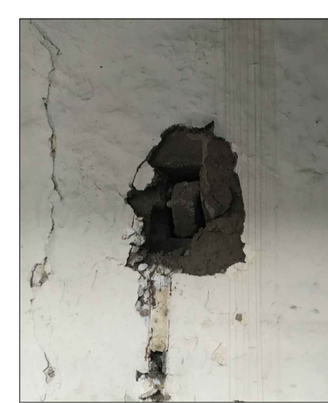
7. RESQUEBRAJAMIENTO DE ENLUCIDO POR INTERVENCIÓN
