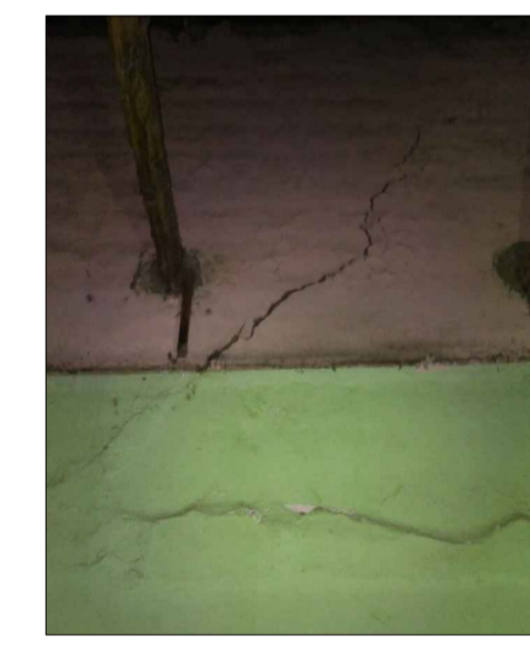
12. RESQUEBRAJAMIENTOS, ESCASO ACCESO DE ILUMINACIÓN Y VENTILACIÓN NATURAL
