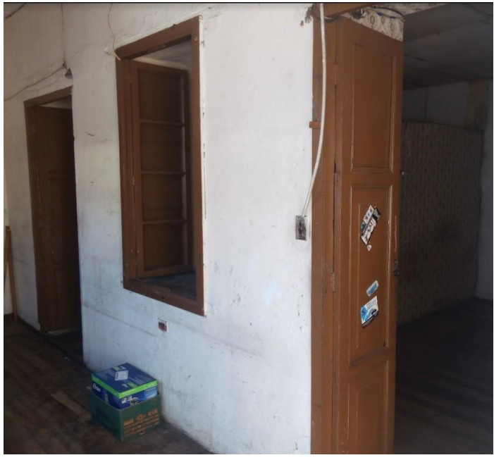
10- Todo el inmueble cuenta con poco acceso de la iluminación y ventilación natural, propiciando la humedad y los espacios fríos.
