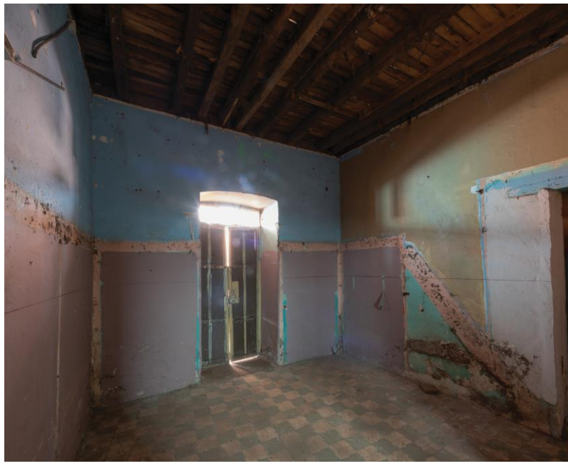
6- Rastros de entre piso de madera añadido. Todo el inmueble cuenta con poco acceso de la iluminación y ventilación natural, propiciando la humedad y los espacios fríos.
