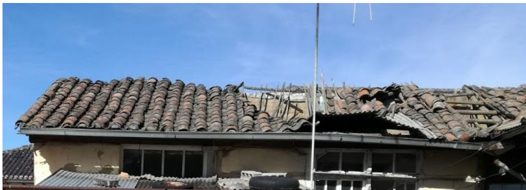
Fotografía N° 1 Deterioro Cubierta Existente
