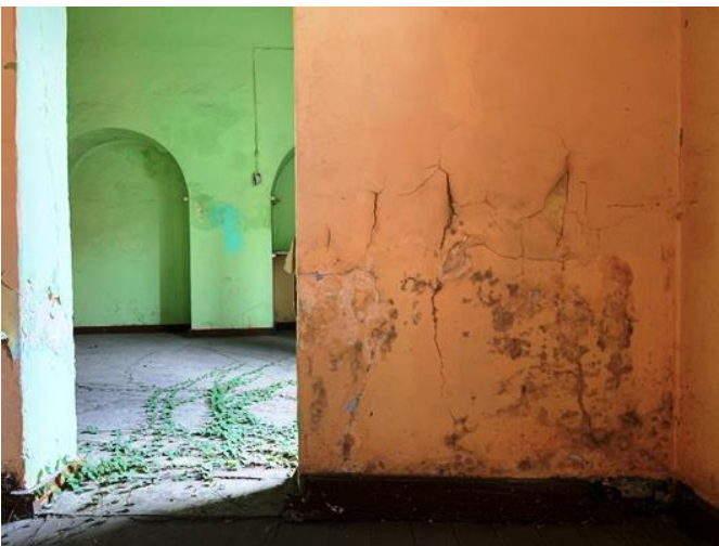
Imagen N°32. Humedad, líquenes y fisuras • Fuente: Ilustración Propia
