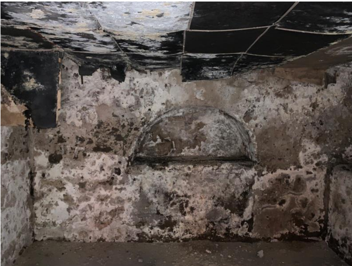
Imagen N°28. Eflorescencias en bodegas • Fuente: Ilustración Propia
