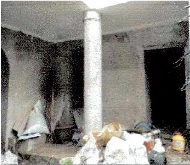
Hall de ingreso al cuarto 2, paredes sin estucar
