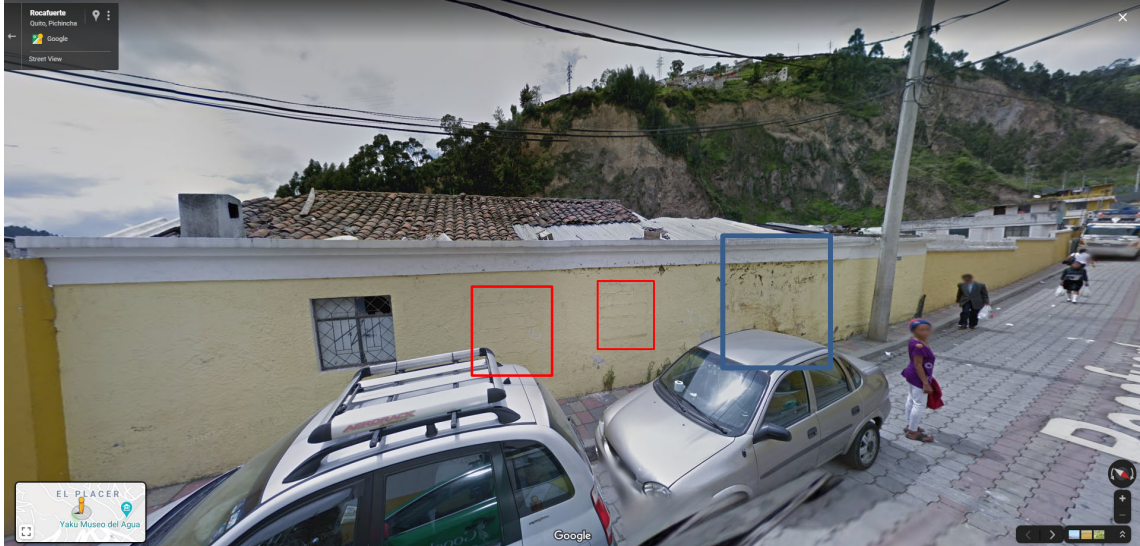
FOTOGRAFIA N 9.- VENTANAS TAPIADAS DE BLOQUE, HUMEDAD EN LA PARED FOTO DE GOOGLE MAPS
