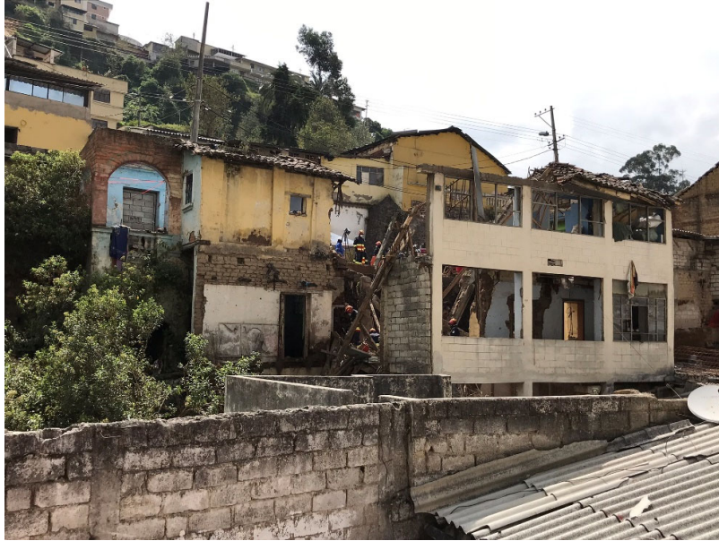
FOTOGRAFIA N 11: COLAPSO POR IMPLOSION DEL INMUEBLE
