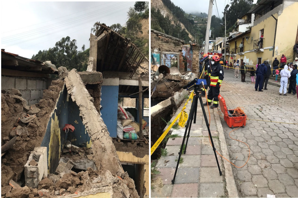
FOTOGRAFIA N 1-2: PATOLOGIA DE CONSTRUCCION MIXTA
