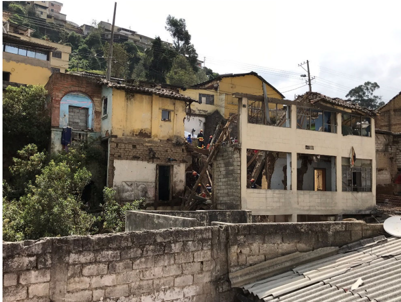
FOTOGRAFIA N 11: COLAPSO POR IMPLOSION DEL INMUEBLE
