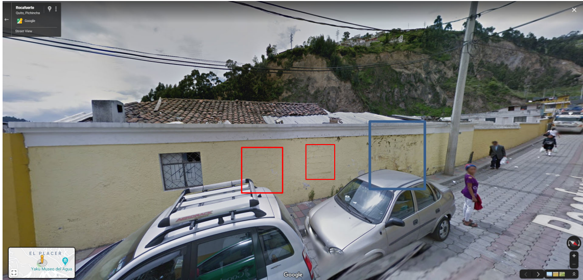
FOTOGRAFIA N 9.- VENTANAS TAPIADAS DE BLOQUE, HUMEDAD EN LA PARED FOTO DE GOOGLE MAPS
