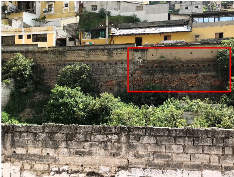
FOTOGRAFIA N 10.- HUMEDAD EN EL MURO COLINDANTE DE ADOBE A PUNTO DE COLAPSAR
