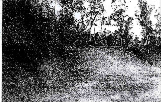
Imagen N°2; Se evidenció que se han realizado trabajos de movimiento de tierras en el cerro Ilaló con la finalidad de abrir un camino anti técnico que sirve para bajar los arboles cortados (pingos) hacia la parte inferior mediante una pala mecánica.
