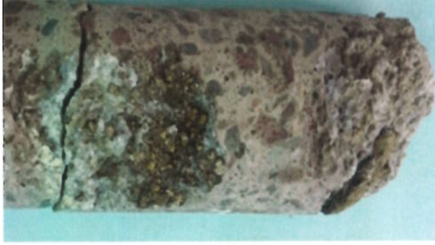
Figura 27: Hormigón contaminado y eflorescencia
