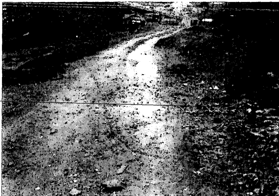
Imagen 1. Calle Camino de los Incas es de tierra en mal estado
