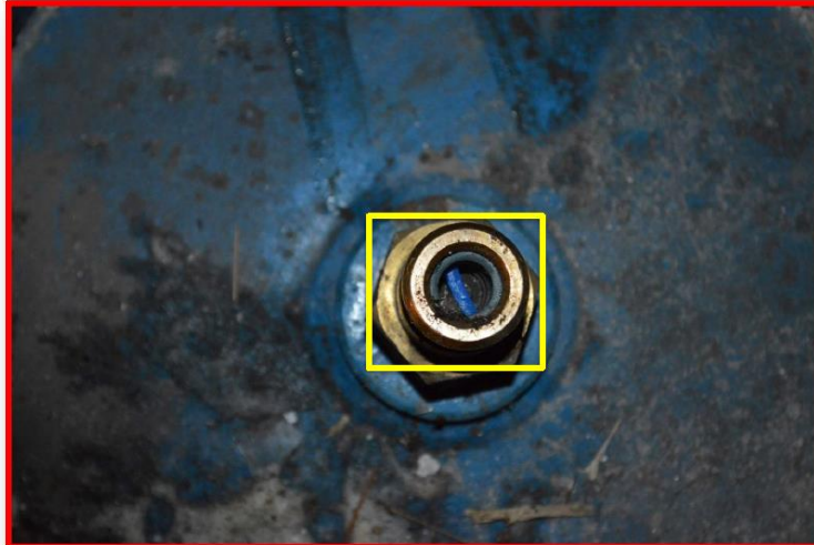
CILINDRO CON ELEMENTO IMPROVISADO PARA CONTROLAR FUGAS DE GAS, (4 CILINDROS EN SIMILAR ESTADO)
