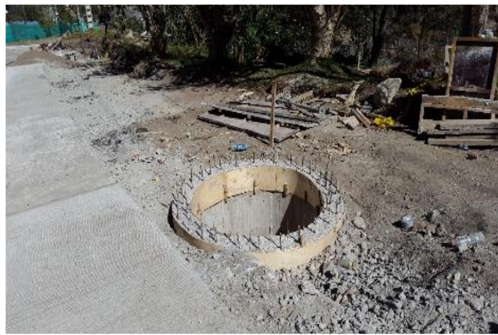
POZOS DE VISITA, ACERO DE REFUERZO EN BARRAS FASE I – PROCESO CONSTRUCTIVO
