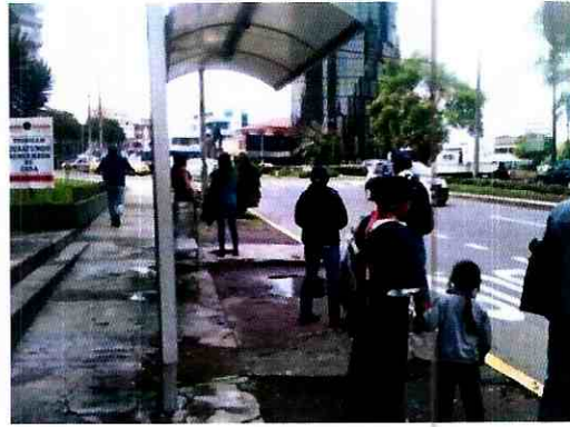
Módulo en acera deteriorada AV. LA CORUÑA SECTOR: PLAZA ARTIGAS
