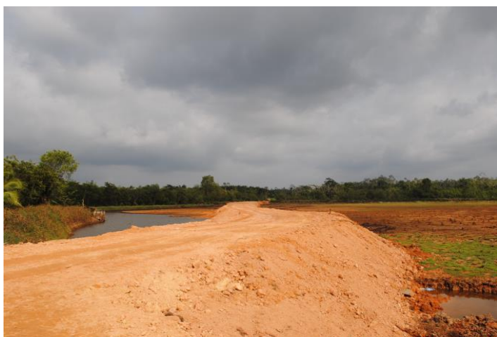
ESTADO ACTUAL DE LA VÍA TAMBILLO – SAN LORENZO
