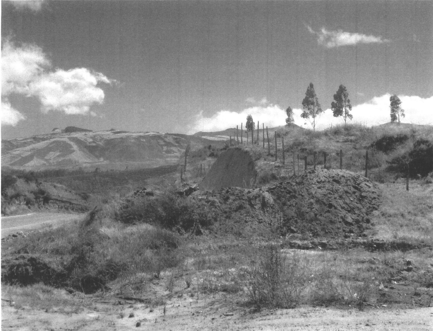
Ampliación vía E-35 (con vista hacia el Oriente) – La parte superior del talud corresponde a los lotes 11 y 12
