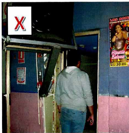
1. Obstrucción del parlante en pasillo.
