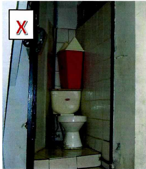
2. Inodoro colocado en esquina, sin cumplir el dimensionamiento mínimo.
