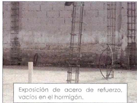
Exposición de aceros de refuerzo, porosidad en el hormigón.
