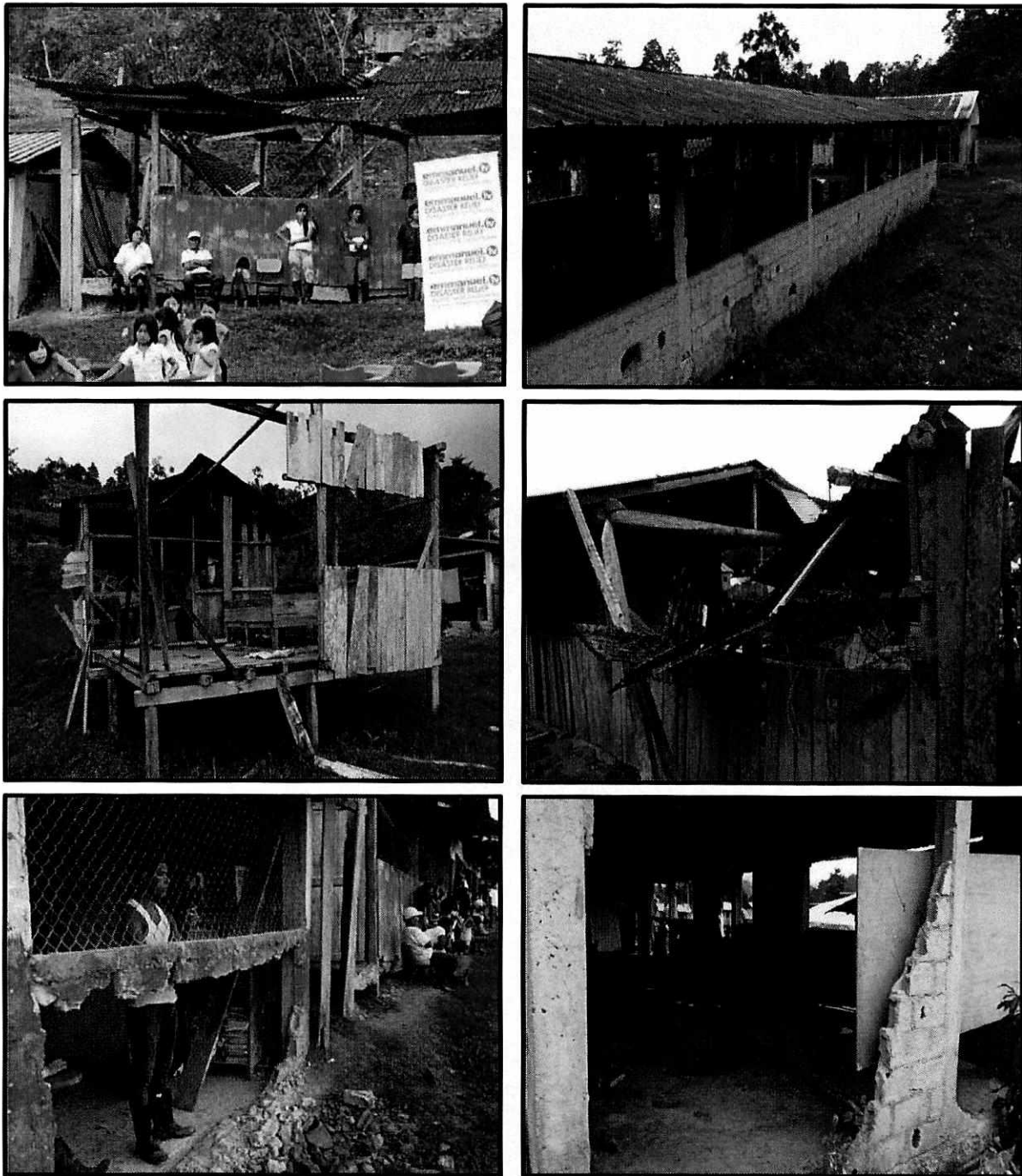
Figura 1. Instalaciones de la unidad educativa Juan Lorenzo Añapa después del terremoto del 16 de abril de 2016.
