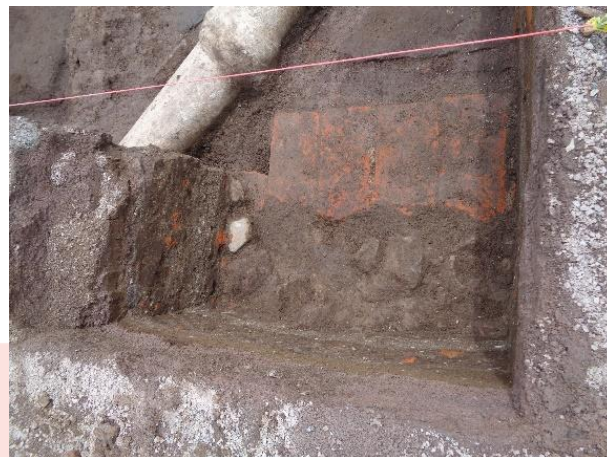
Foto 67 Unidad 11 Intrusión de tubería, en basamento de piedra y ducto cajón
