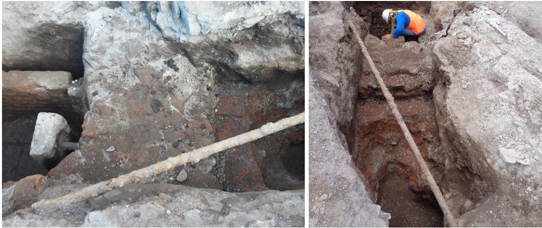
Foto 86 y 87 Unidad 20 Detalles de ducto matriz
