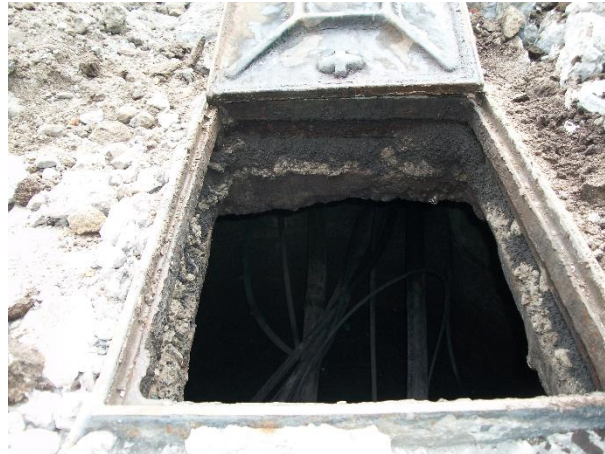
Foto 31 Detalle de ducto para fibra óptica.
