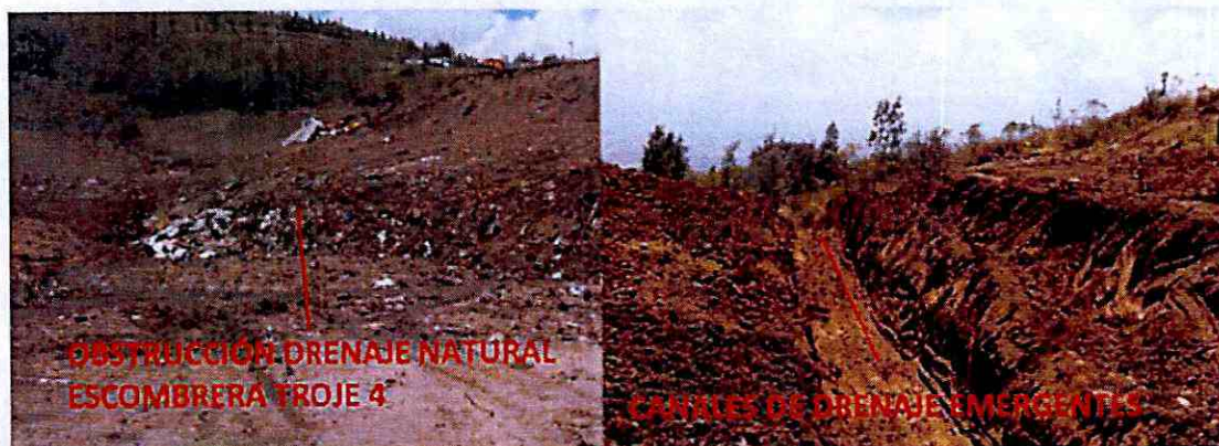
Gráfico No. 7 Drenaje natural afectado por aluviones producidos desde la escombrera El Troje
