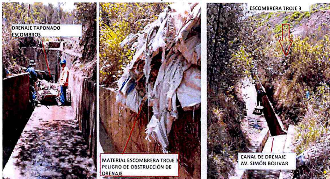
Gráfico No. 9 Problemas en Escombrera 3, gestionada por la EPMMOP.
