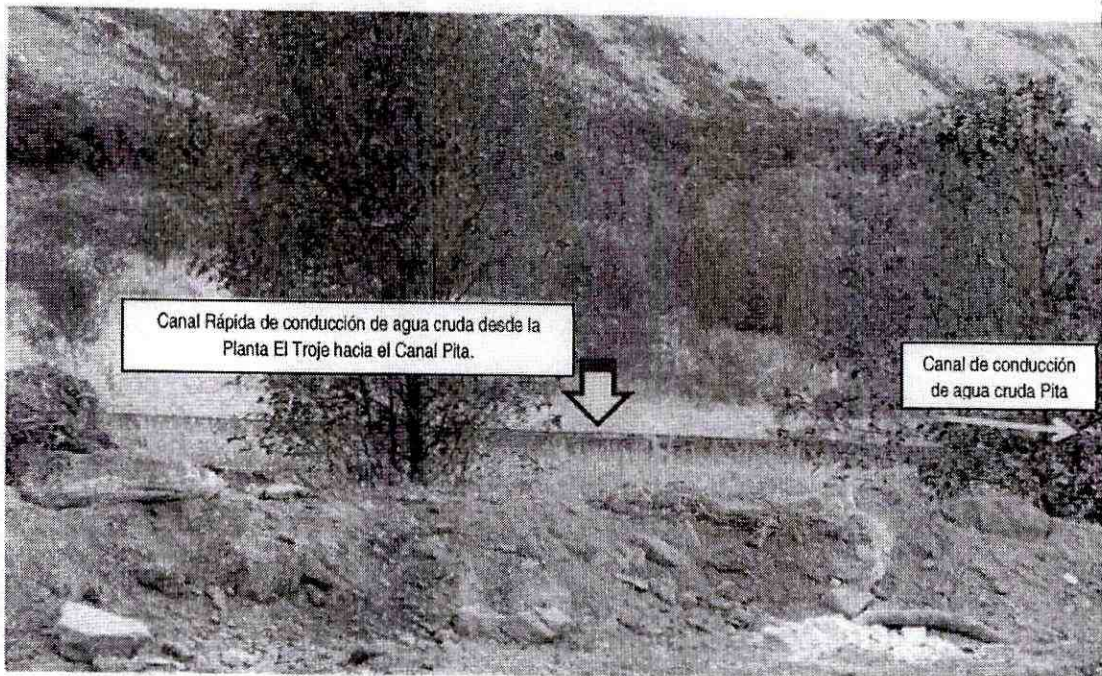
Material de relleno de la Escombrera cerca a canal de Rápida de conducción agua cruda hacia el canal Pita
