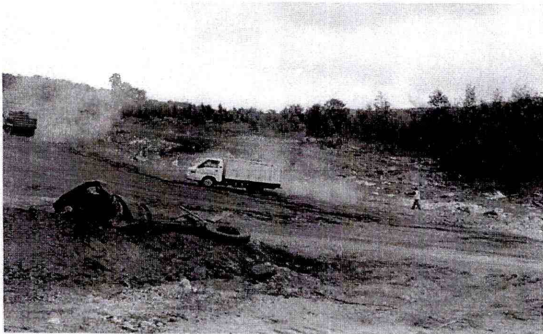
Se evidencia emisión de polvo, contaminando el área circundante y el agua del Canal de la Rápida. Se puede apreciar materiales no aptos para este tipo de Escombrera.
