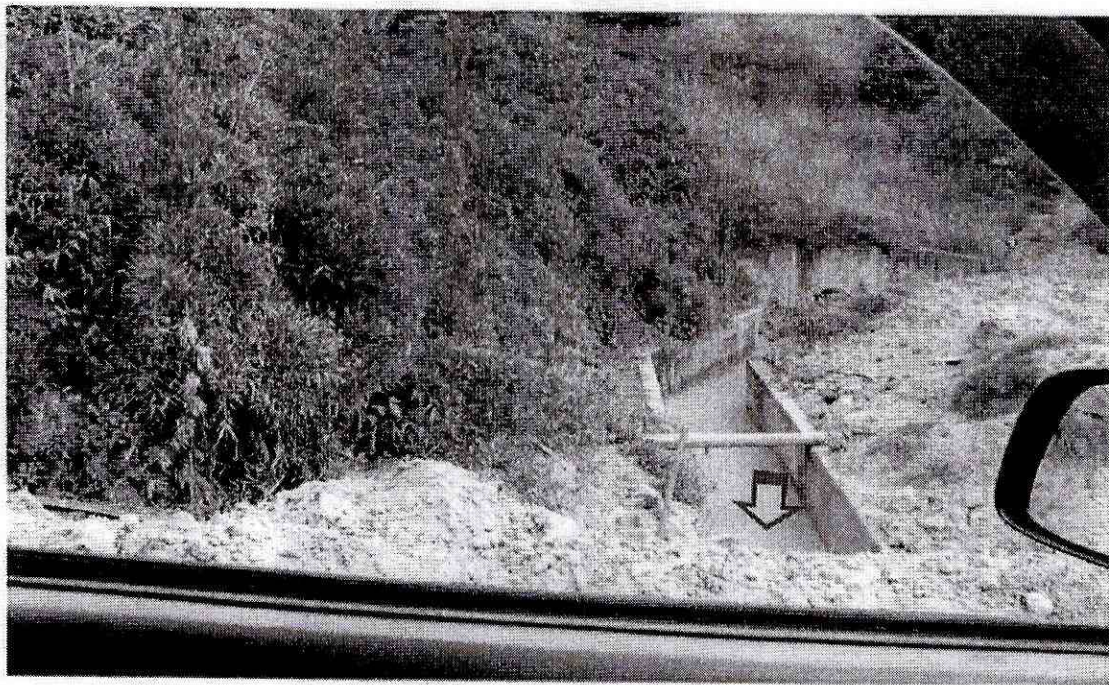
Obstrucción de infraestructura para drenaje de agua de la Planta Tratamiento El Troje
