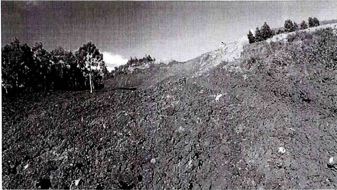
Fotografía 1. Sitio del deslizamiento de tierras de la escombrera sobre el canal del Pita.
