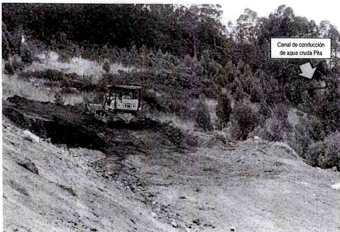
Obras de relleno de la Escombrera cercanas al Canal de conducción Pita.
