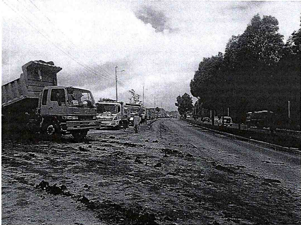
Estado de la Av. Simón Bolívar y la vía de acceso a la escombrera El Troje 4. 20/05/2017
