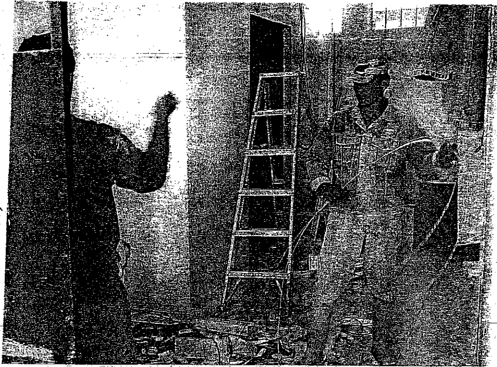
Trabajadores municipales trabajando en la adecuación de los locales para la ubicación de los cuartos fríos en el chaco.
