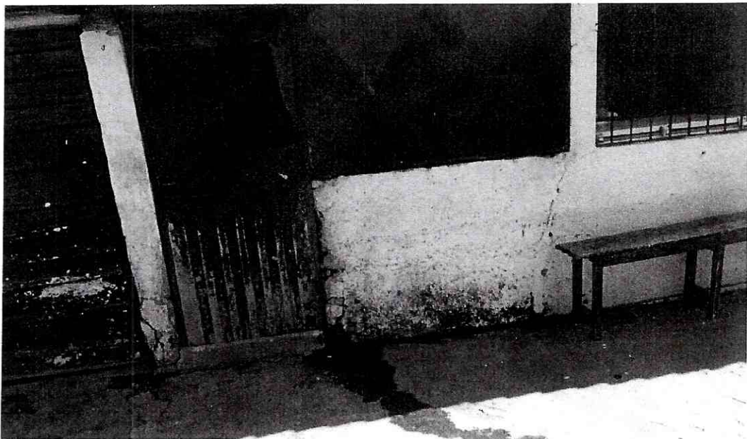
puestos con humedad.
