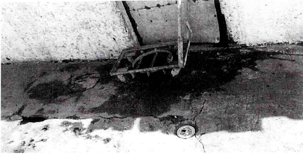
puertas en mal estado y piso no adecuado.
