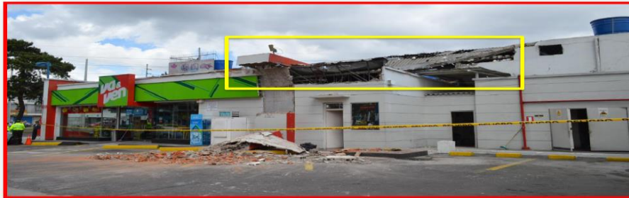
DAÑO ESTRUCTURAL SUR ALEDAÑO A LA CENTRALITA CLANDESTINA
