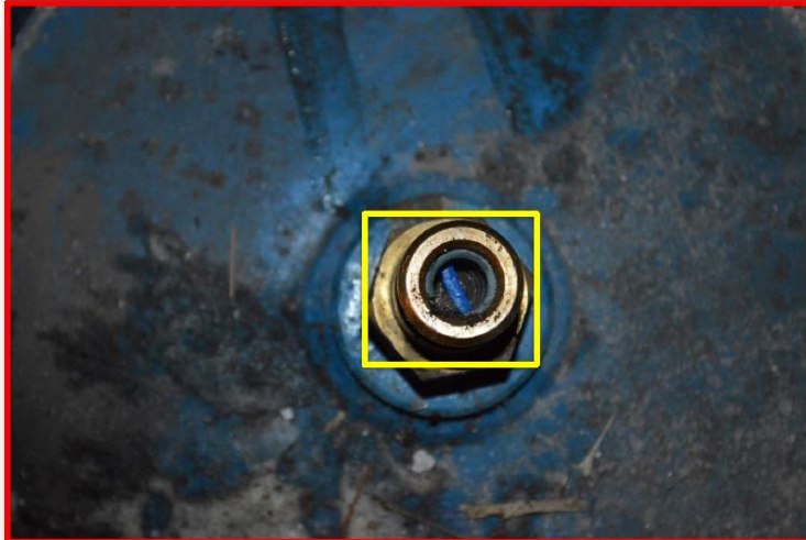
CILINDRO CON ELEMENTO IMPROVISADO PARA CONTROLAR FUGAS DE GAS, (4 CILINDROS EN SIMILAR ESTADO)
