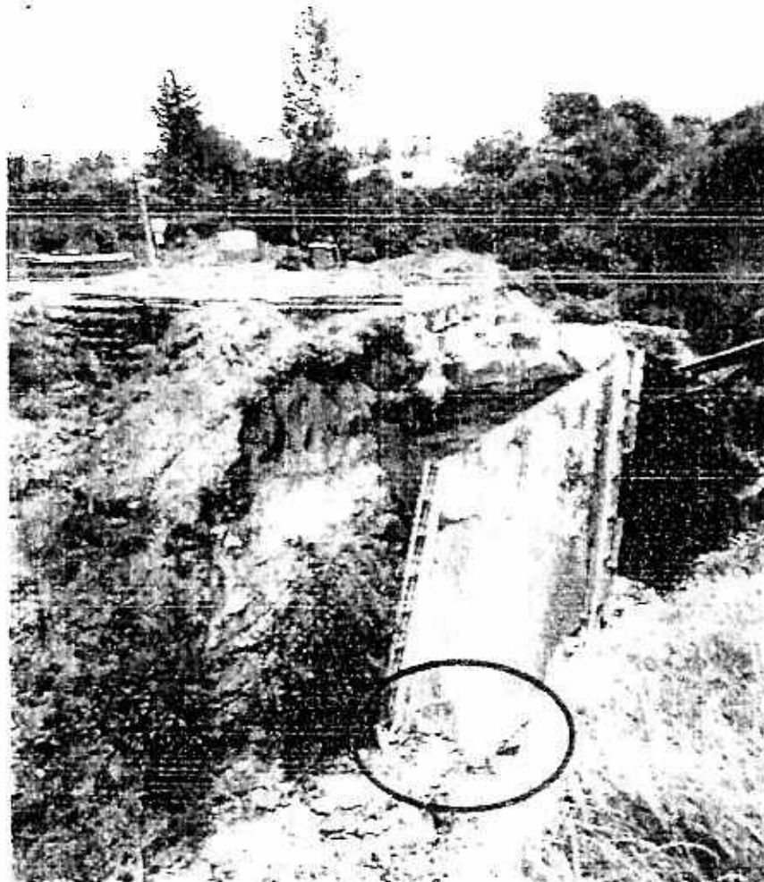
Estructura colapsada, impidiendo la libre circulación del cauce.
