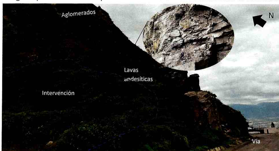
Foto. Abscisa 1+350, Basculamiento de columnas de rocas.
