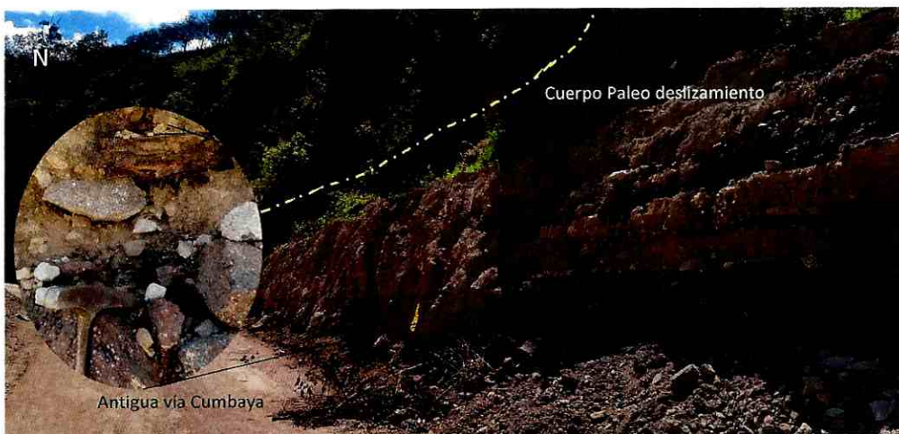
Foto. Abscisa 0+680, Paleo-deslizamiento ligeramente consolidado.
