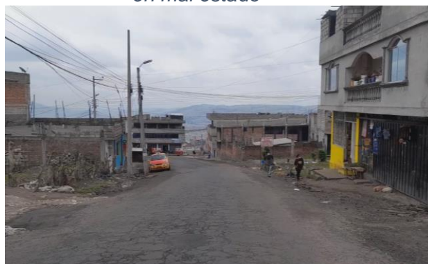
FOTO 2: "calle Arrayanes, tramo asfaltado en mal estado"
