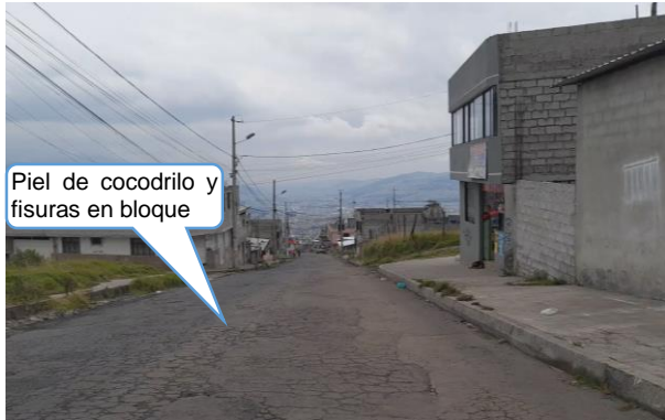
FOTO 5: "Estado Actual del Asfalto deteriorado"
