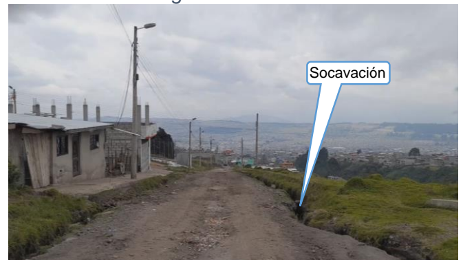
FOTO 10: "Socavación de la calzada por las aguas lluvia"
