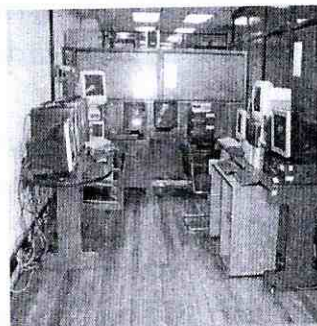
DATA CENTER ANTES
